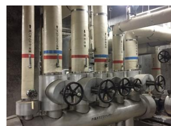
〔地下にあるボイラー室〕
