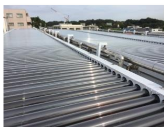
〔屋上にあるガラス管〕
